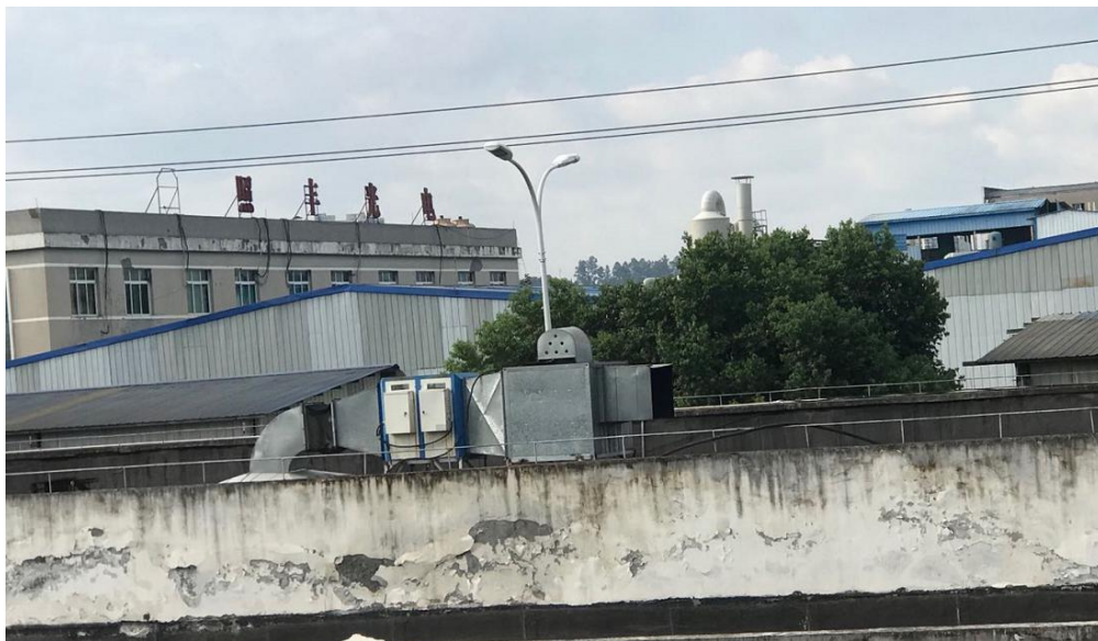
图 4.2-4 项目食堂楼顶油烟净化器
