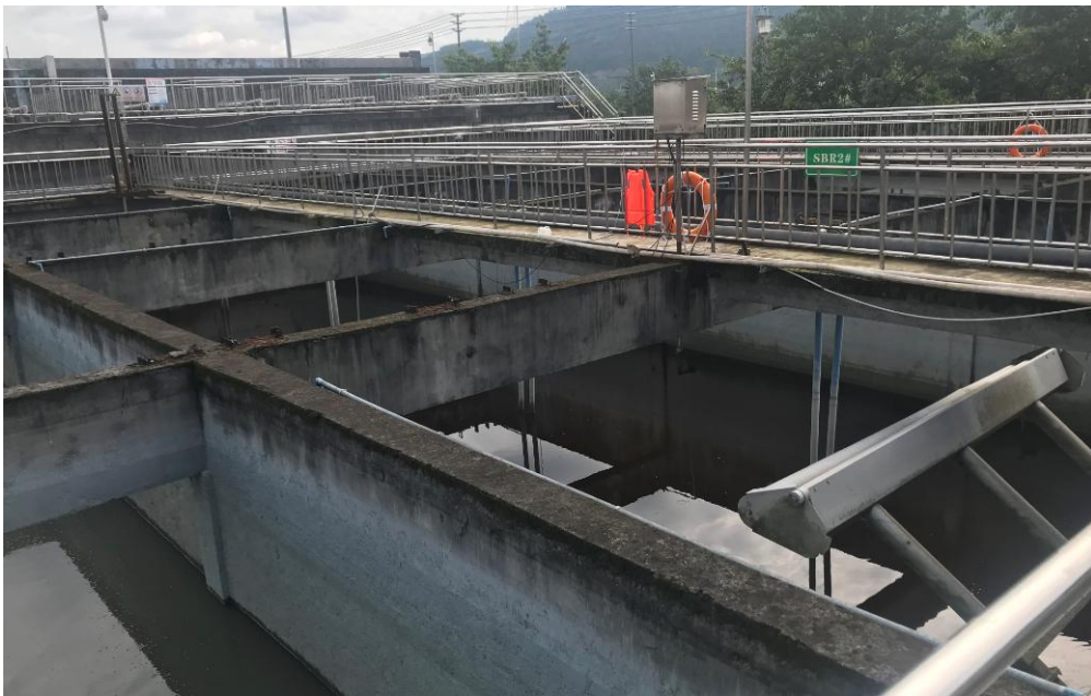
图 4.2-1 项目污水处理池未加盖
