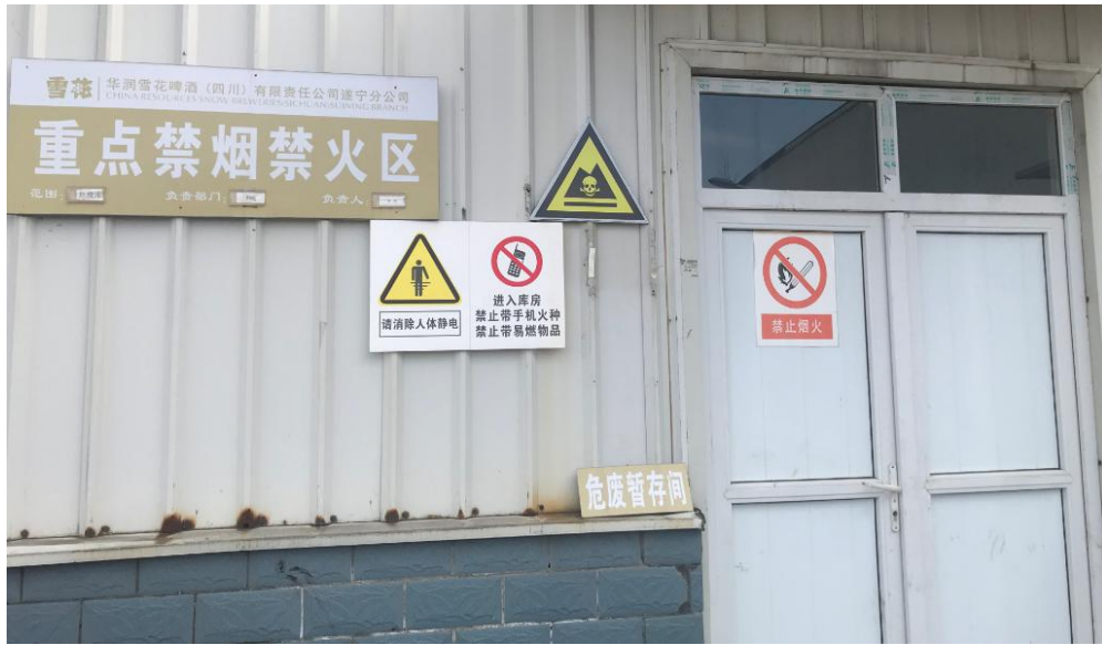
图 4.5-1 项目危废暂存间外标示不清
